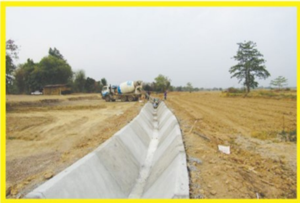
ลำเหมืองดาดคอนกรีตเสริมเหล็ก สายทุ่งนาป่า หมู่ที่ ๒ ตำบลชัยชุมพล
